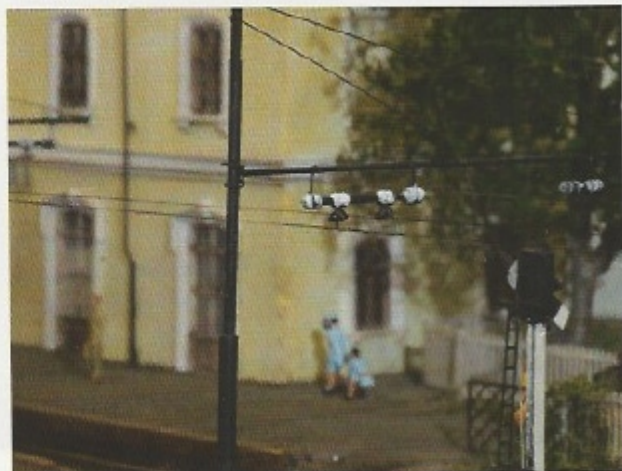
Draaistroom vergt dubbele en van elkaar geïsoleerd opgehangen rijdraden.
